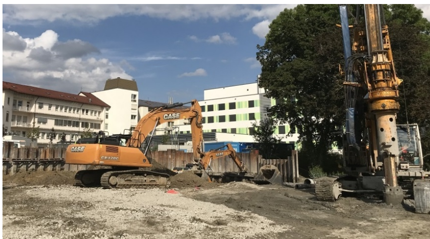
Direkt hinter der Zufahrt zum Klinikum Crailsheim entsteht ein Parkhaus mit 276 Stellplätzen.
